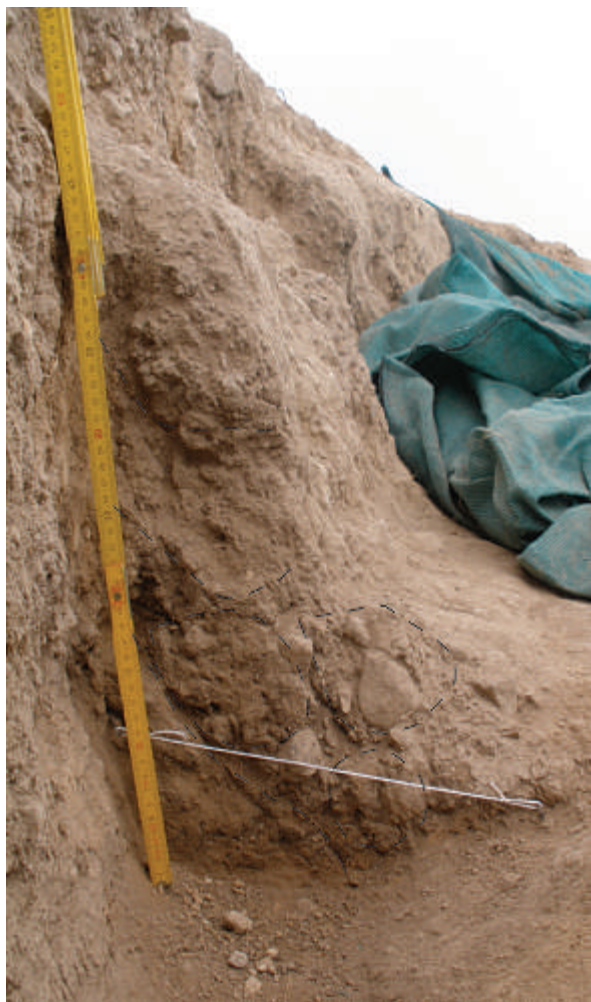
Fig. 2 – Mur périphérique. La partie inférieure est ancrée dans la tranchée de fondation (phase 1); la partie supérieure appartient à la phase 2.
