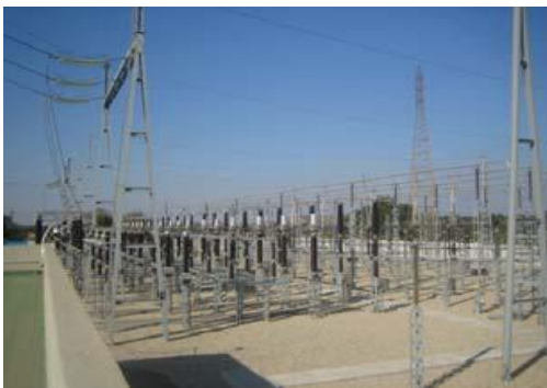
Poste de transformation
