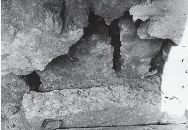
Fig. 7 – Blocs éboulés dans le secteur ouest de la cavité.
