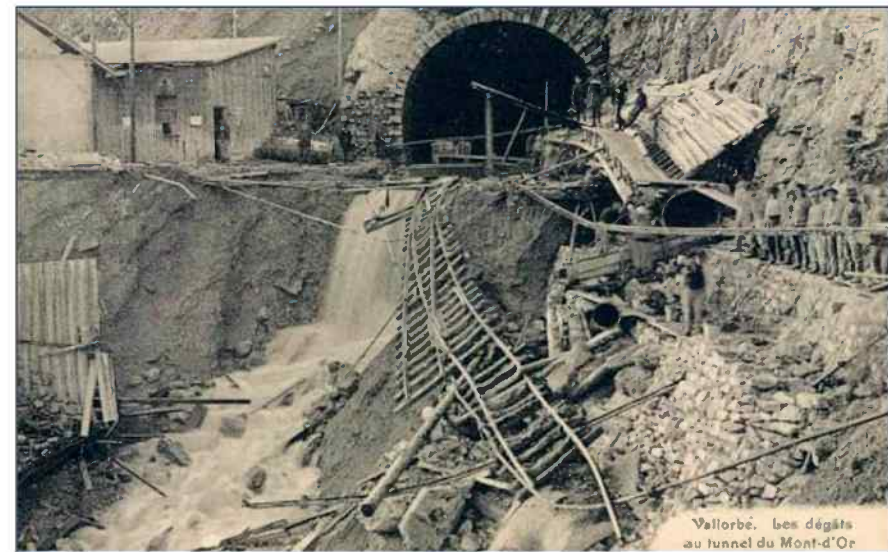
Exhaure de l'eau et dommages sur la plateforme d'entrée.
