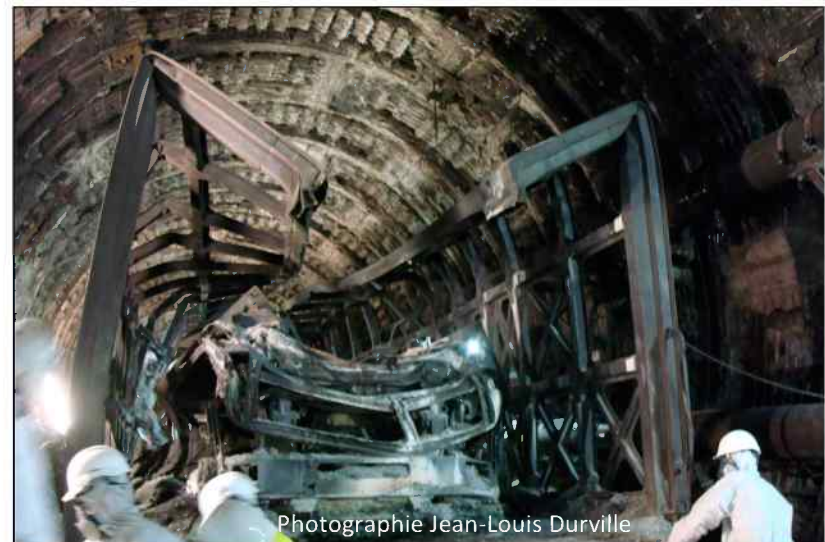
Incendie de 2008. Vue des dommages dans le tunnel après l'incendie
