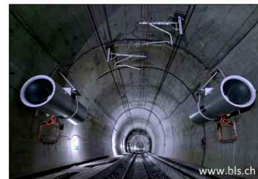
Tunnel du Lötschberg entièrement équipé
