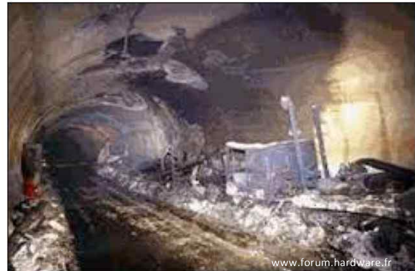
Incendie de 1996. Vue générale des dommages dans le tunnel
